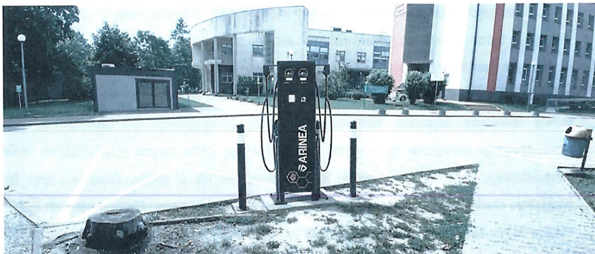
Przykładowe zabezpieczenie Stacji ładowania
